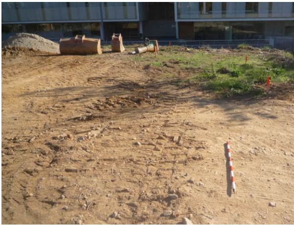
43. Ubicació de la Rasa 8 al solar E del Passeig Torras i Bages
